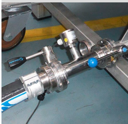
Vue du NCS-L-12/18 en place
