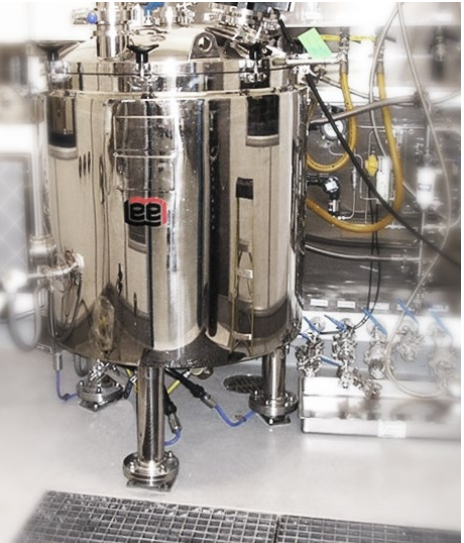
Contrôle du contenu des cuves de process
