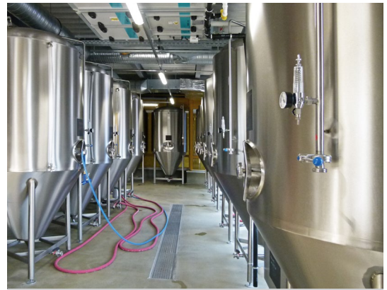
Le remplissage des cuves de stockage est surveillé par des FMQ
